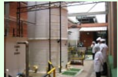
Betriebliche Kläranlage in Bogota
